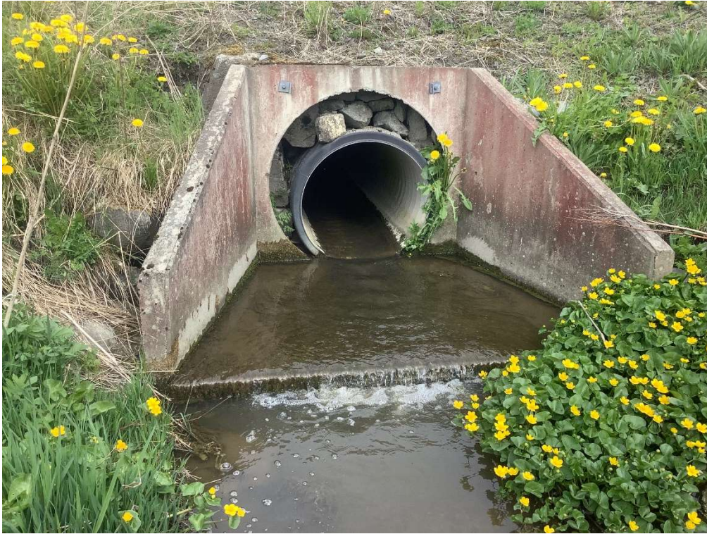
Figur 2-3. Kulvert gjennom fylkesveg FV753 med diameter på 800 mm (Kilde: https://vegkart.atlas.vegvesen.no ).
